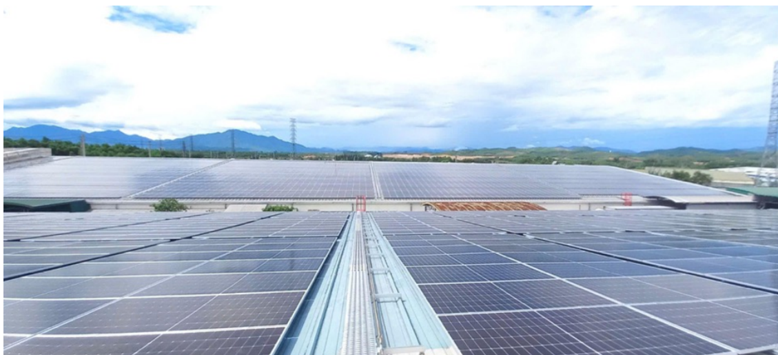
Hệ thống điện mặt trời tại nhà máy Sợi Phú An - Huế
