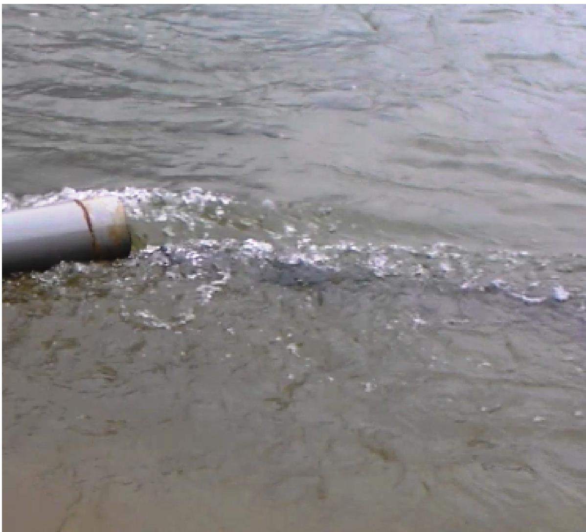
Đường ống xả thải của Công ty Tinh bột sắn Bá Thước ra sông Mã (Ảnh cắt từ clip do người dân cung cấp)
