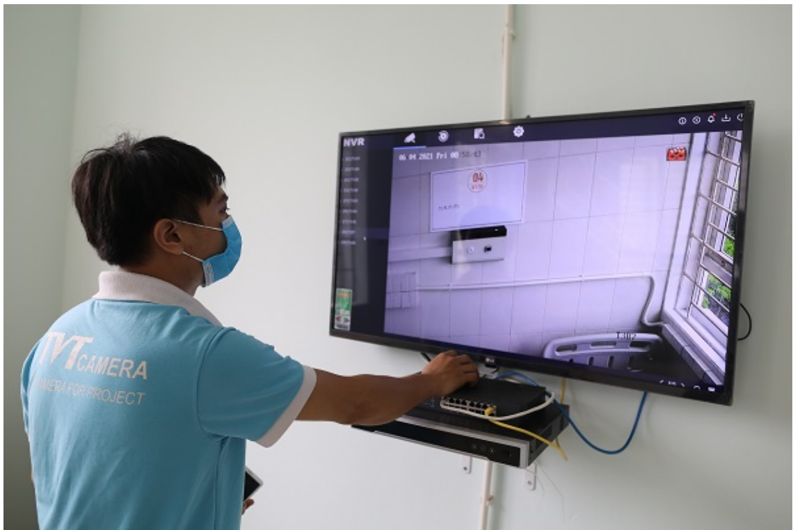
Hệ thống 54 camera tại 4 tầng được truyền về phòng điều hành.
