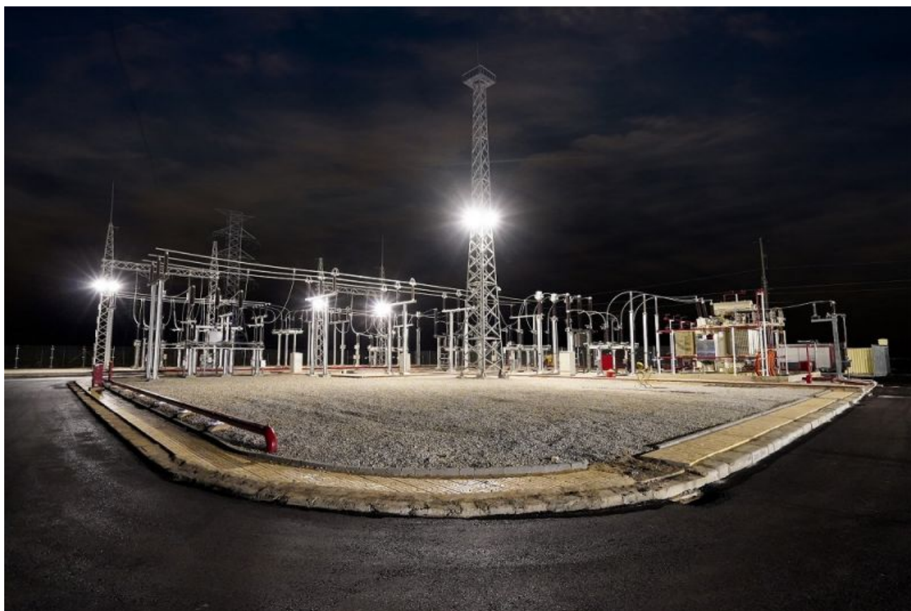
Nhà máy điện mặt trời Phước Ninh chính thức hòa lưới điện quốc gia vào tối ngày 10/06/2020
