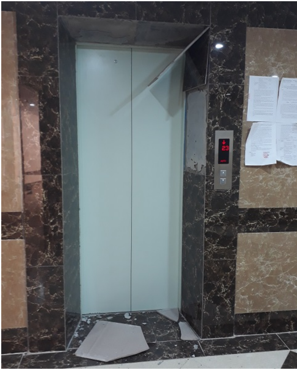
Hình ảnh PV ghi nhận tại thang máy ĐN2 tầng 23, tòa T2
