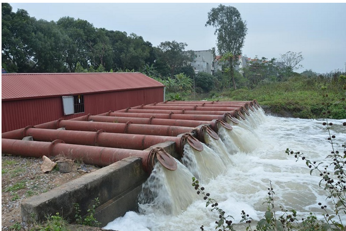
Trạm bơm nông nghiệp hoạt động phục vụ nước đổ ải và gieo cấy
