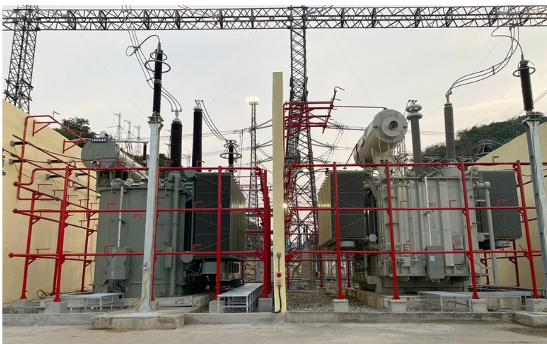
TBA 500 kV Hòa Bình được nâng công suất từ 1350 MVA lên 1800 MVA- Ảnh:VGP/Toàn Thắng
