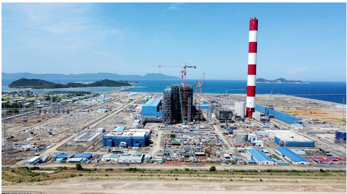
Dự án Nhà máy nhiệt điện Vân Phong 1
