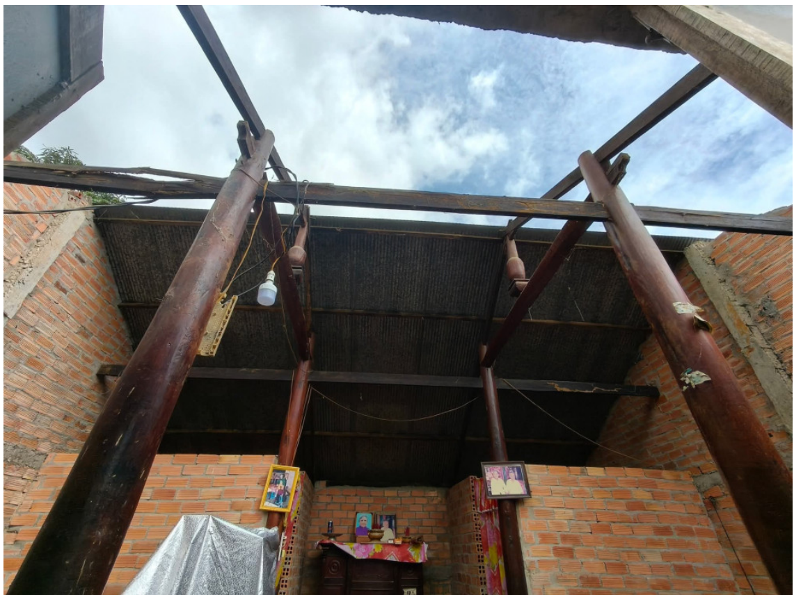
Một căn nhà bị tốc mái do lốc
