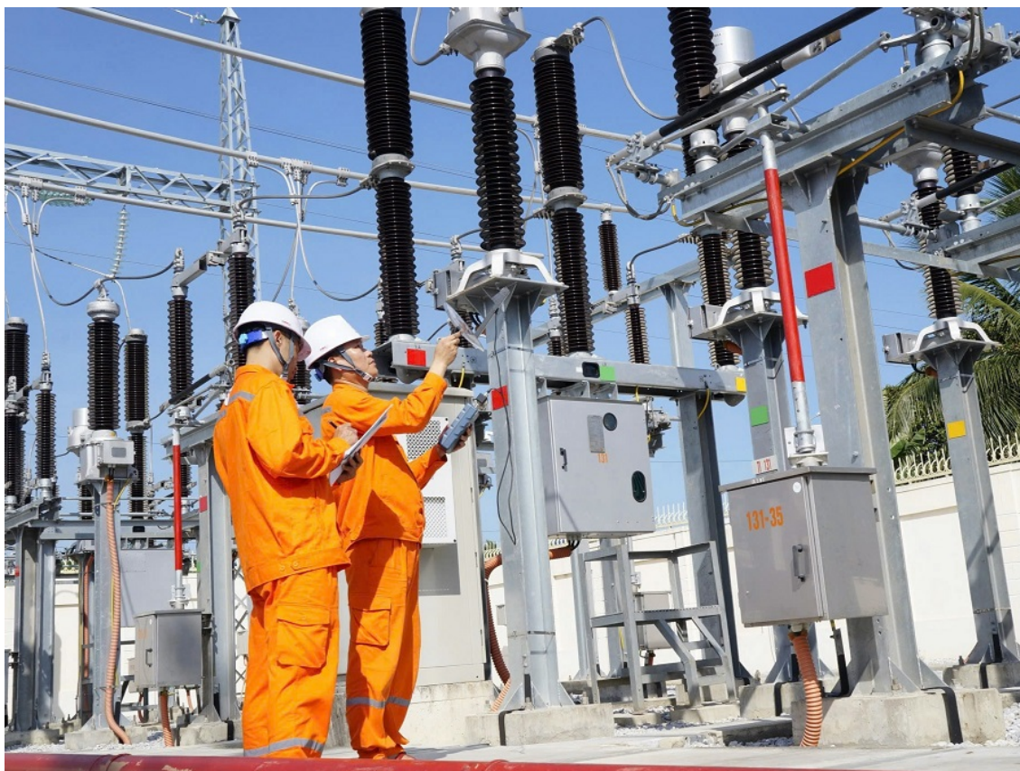
Công nhân Xí nghiệp 110kV (Công ty Điện lực Thanh Hóa) kiểm tra vận hành thiết bị
