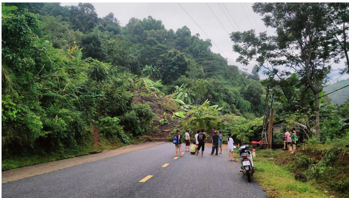
Điểm sạt lở trên tuyến QL15C gần cổng Trường PTDT BÁN TRÚ THCS Pù Nhi, huyện Mường Lát, tỉnh Thanh Hóa
