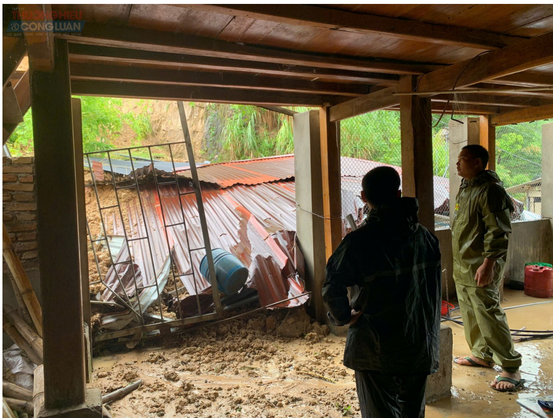
Bão lũ đã làm hư hỏng 69 ngôi nhà trên địa bàn tỉnh Thanh Hóa
