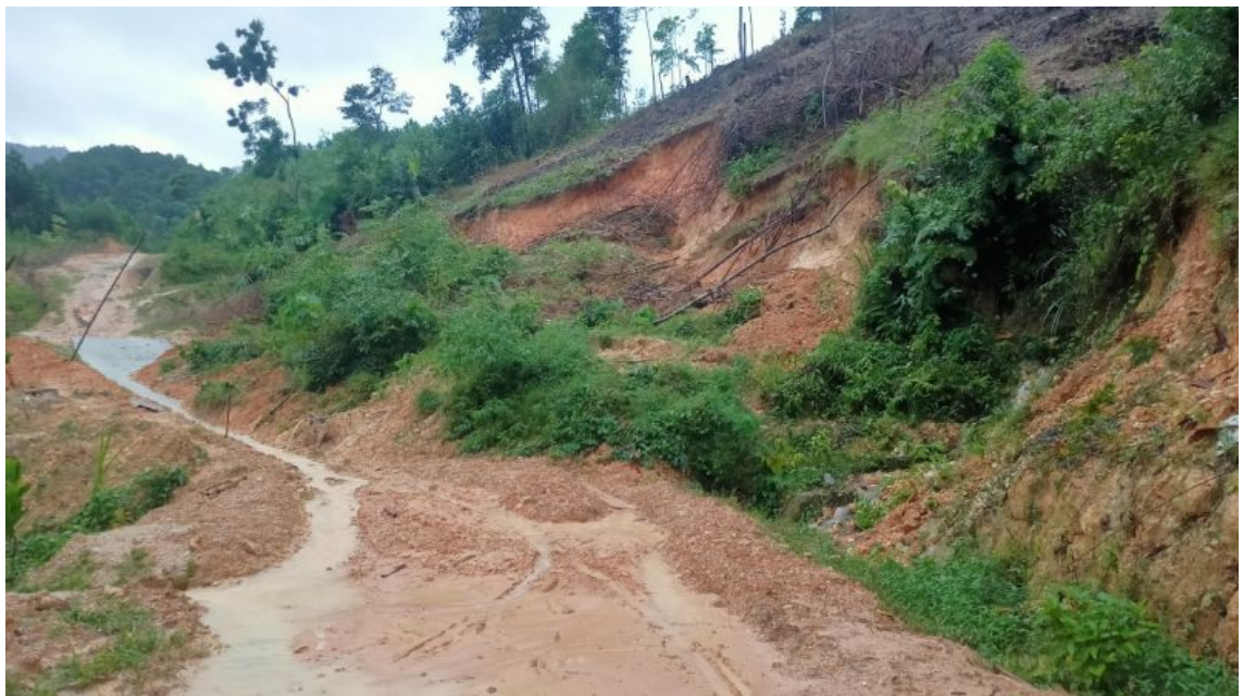
Mưa lớn gây sạt lở tại huyện miền núi Thường Xuân, tỉnh Thanh Hoá.
