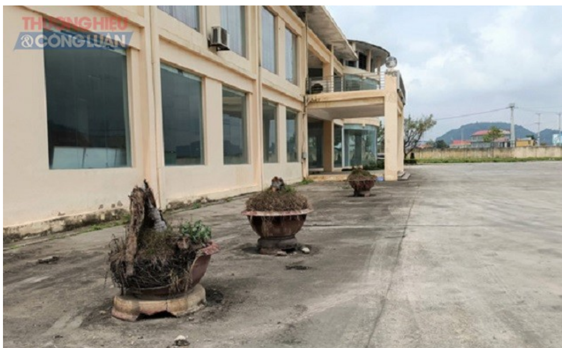
Nhiều hạng mục công trình đã hư hỏng, xuống cấp nghiêm trọng.
