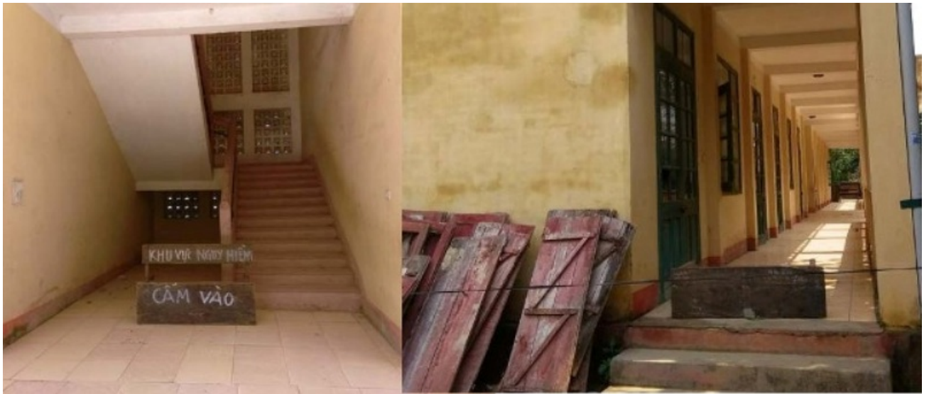
Biển cảnh báo được dựng tạm tại dãy nhà 2 tầng Trường Tiểu học Hợp Lý
