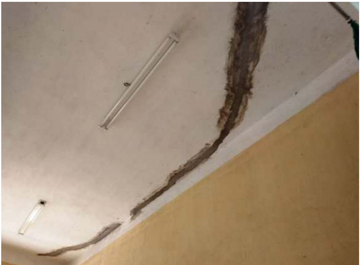
Những vết nứt cũ được gắn xi măng tại phòng thư viện của Trường Tiểu học xã Hợp Lý
