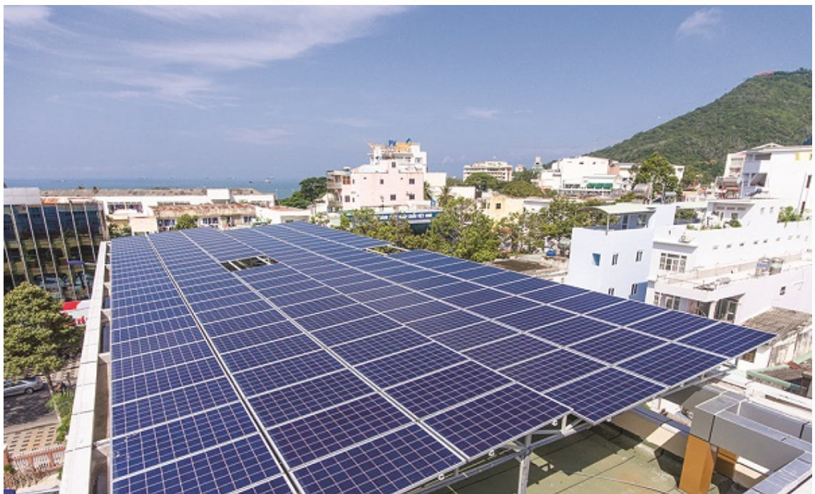
Điện mặt trời mái nhà.
