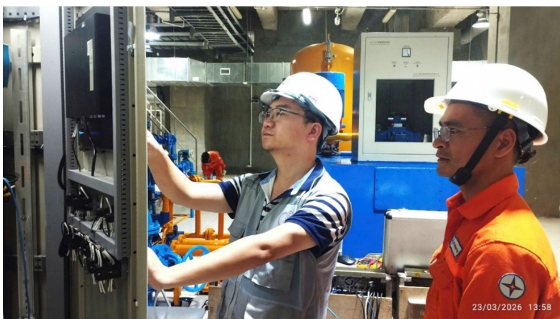
Chuyên gia và Kỹ sư Công ty Thủy điện Buôn Kuốp kiểm tra hệ thống điều tốc mới
