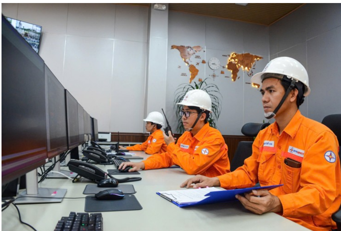
Phân xưởng Vận hành theo dõi, giám sát thiết bị tại Phòng điều khiển Trung tâm Nhà máy Thủy điện Đồng Nai 4
