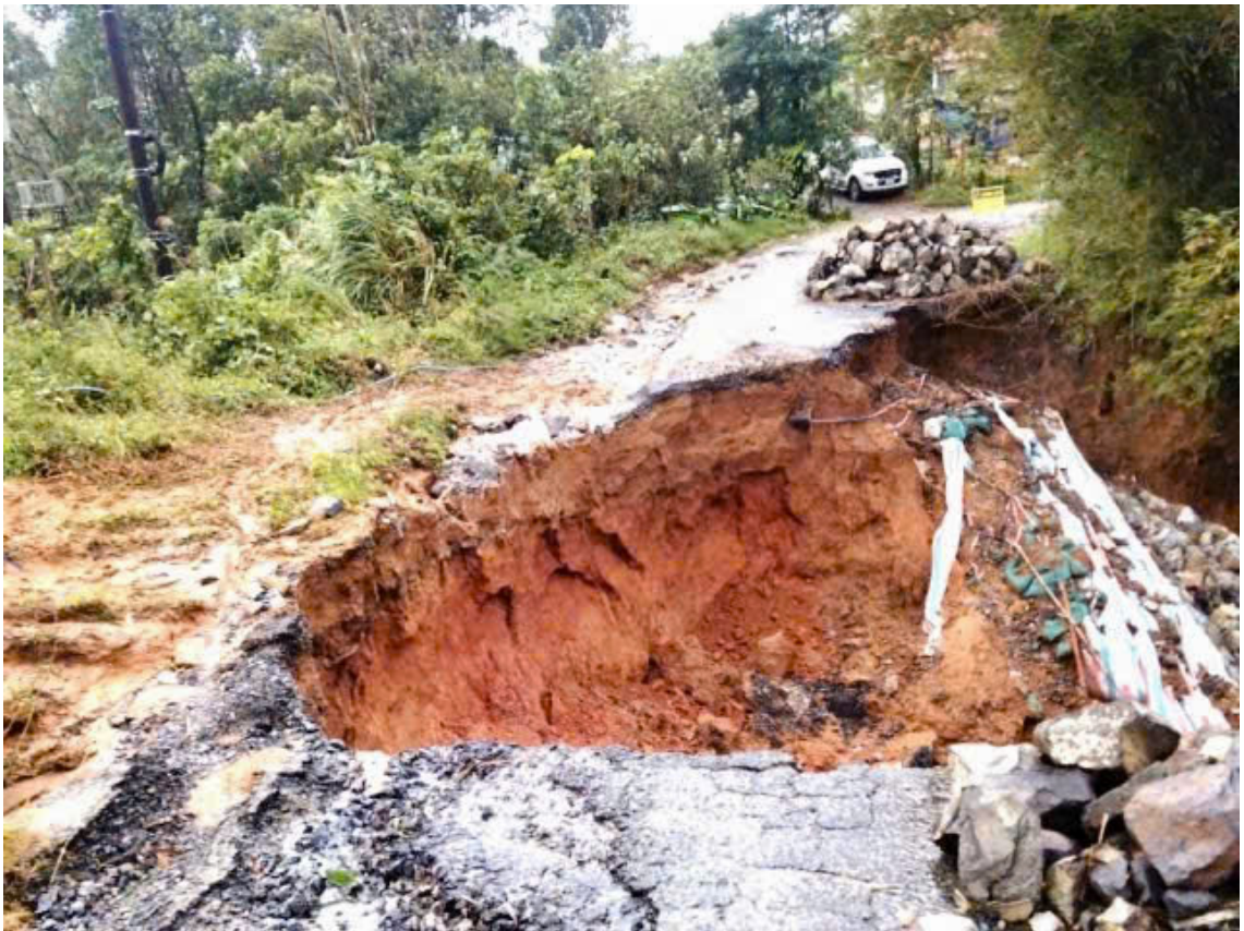
Tỉnh lộ 587 bị sạt lở nghiêm trọng, gây nguy hiểm cho người đi đường
