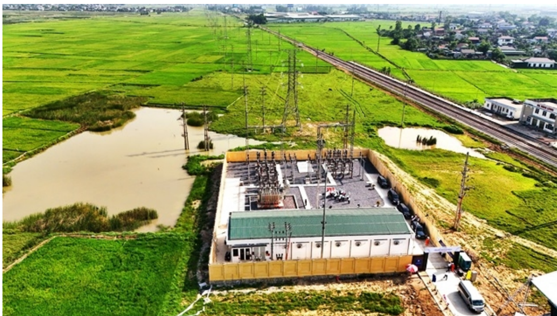
Toàn cảnh trạm biến áp 110kV Nam Cắm
