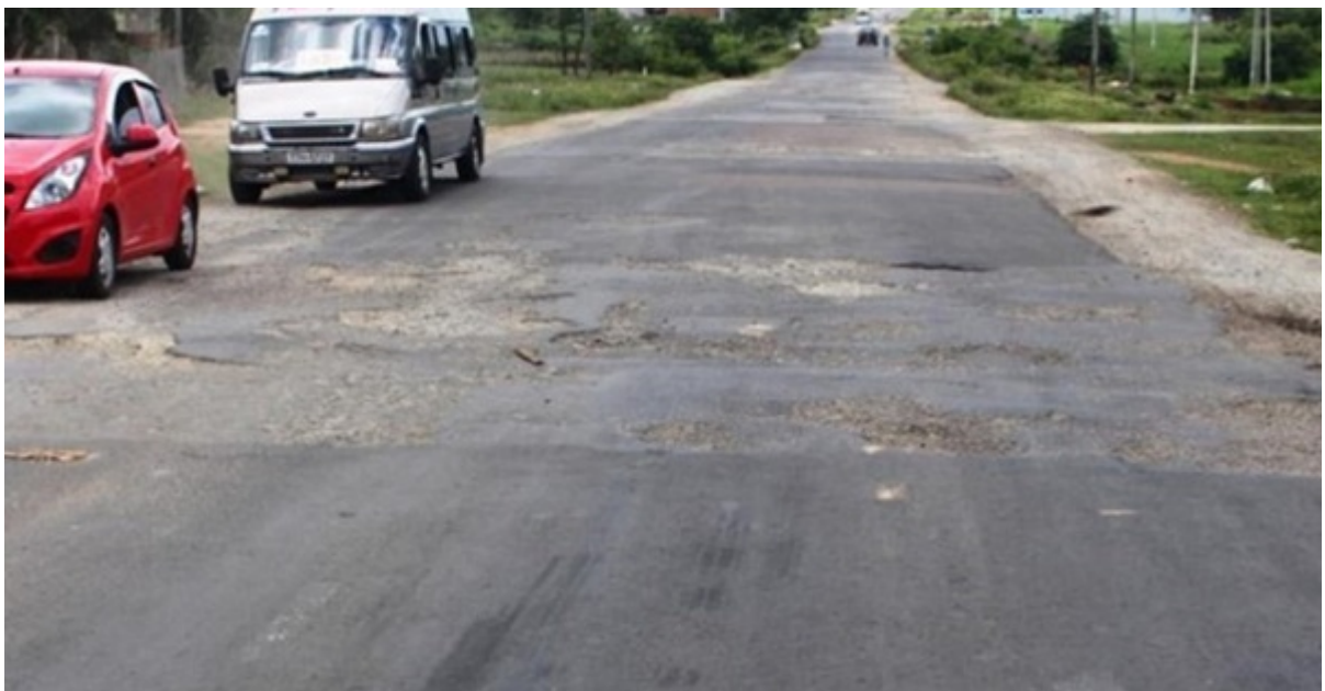
Quốc lộ 19 xuống cấp, chờ sửa chữa
