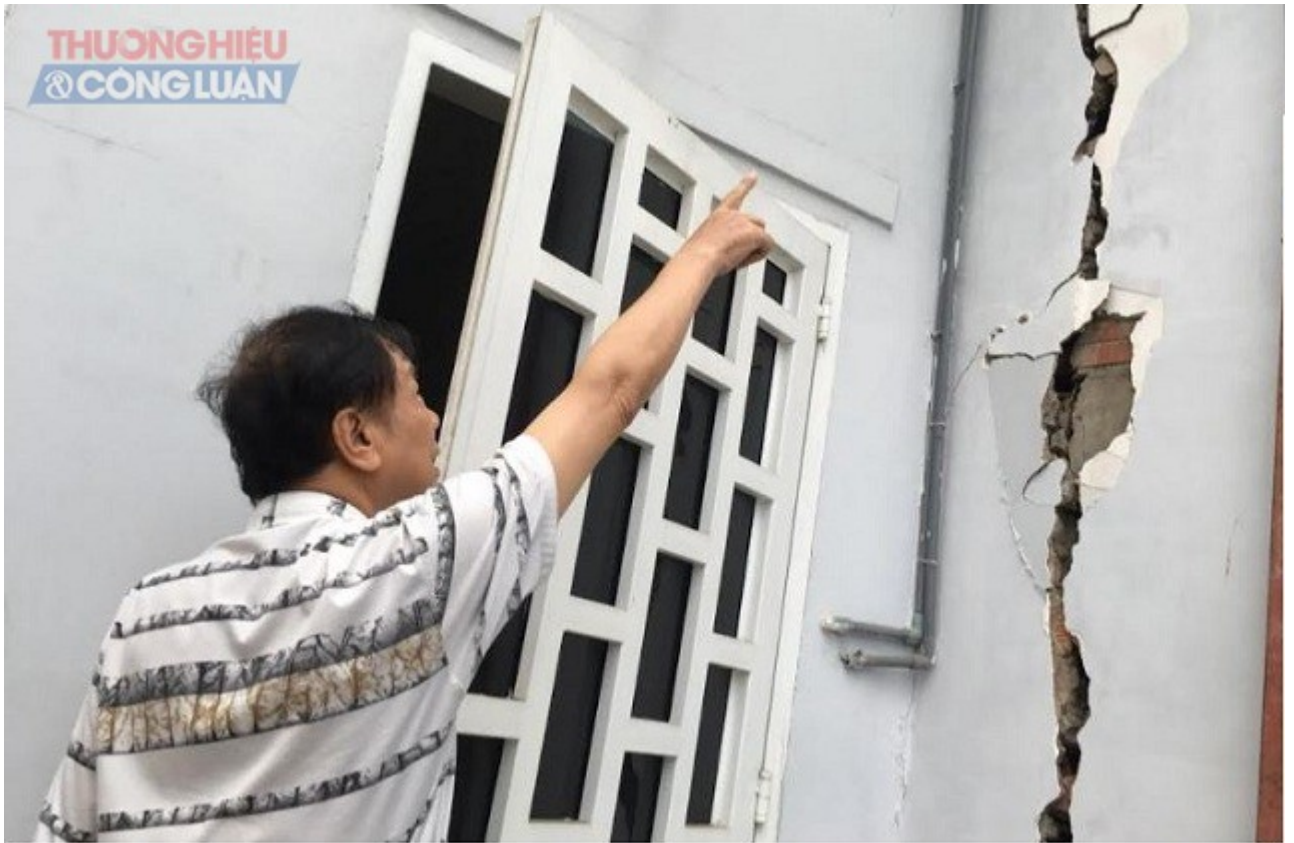
Căn nhà số nhà 20 bị nứt, có những vết nứt rộng đến 7cm
