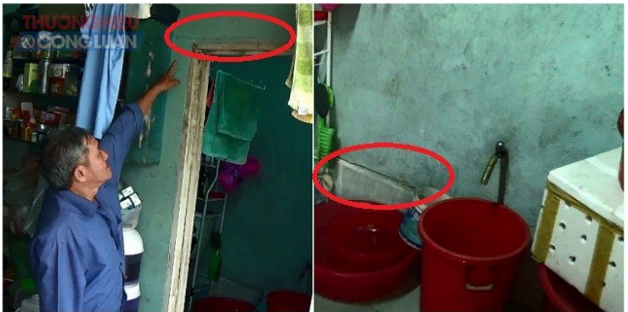
Nhiều căn nhà bị nứt do ảnh hưởng bởi dự án Carillon 7
