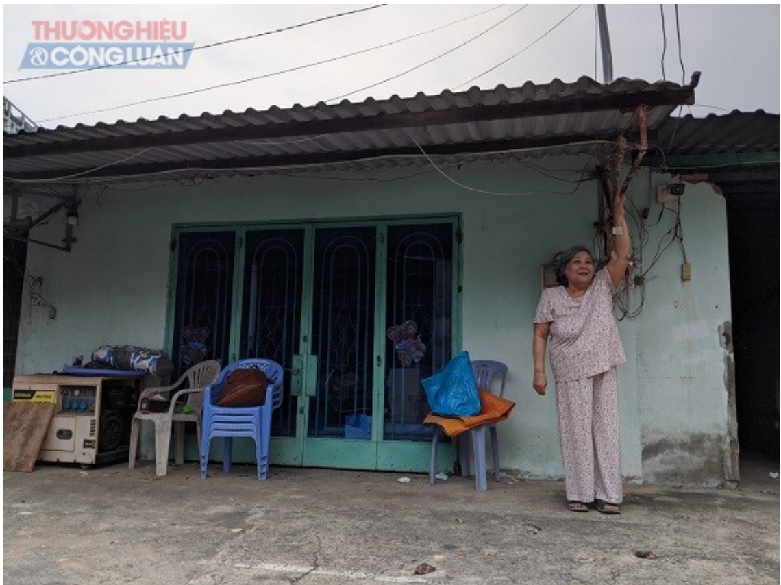
Dù nhà đã xuống cấp nhiều năm nay nhưng gia đình bà Tiết không thể xây lại bởi "dính" quy hoạch. (Ảnh: PV)
