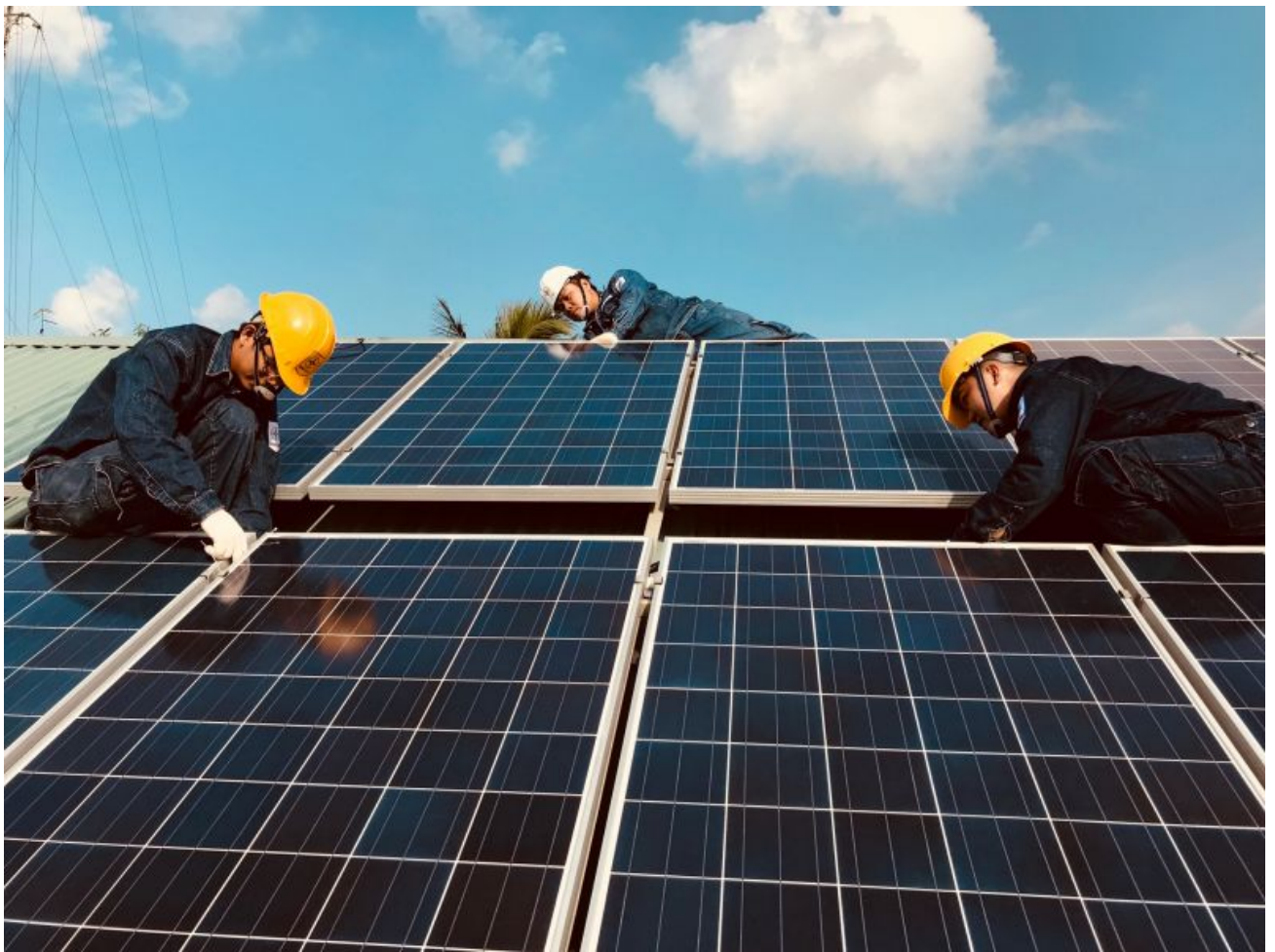
Công trình điện mặt trời trên mái nhà tại TP. Hồ Chí Minh
