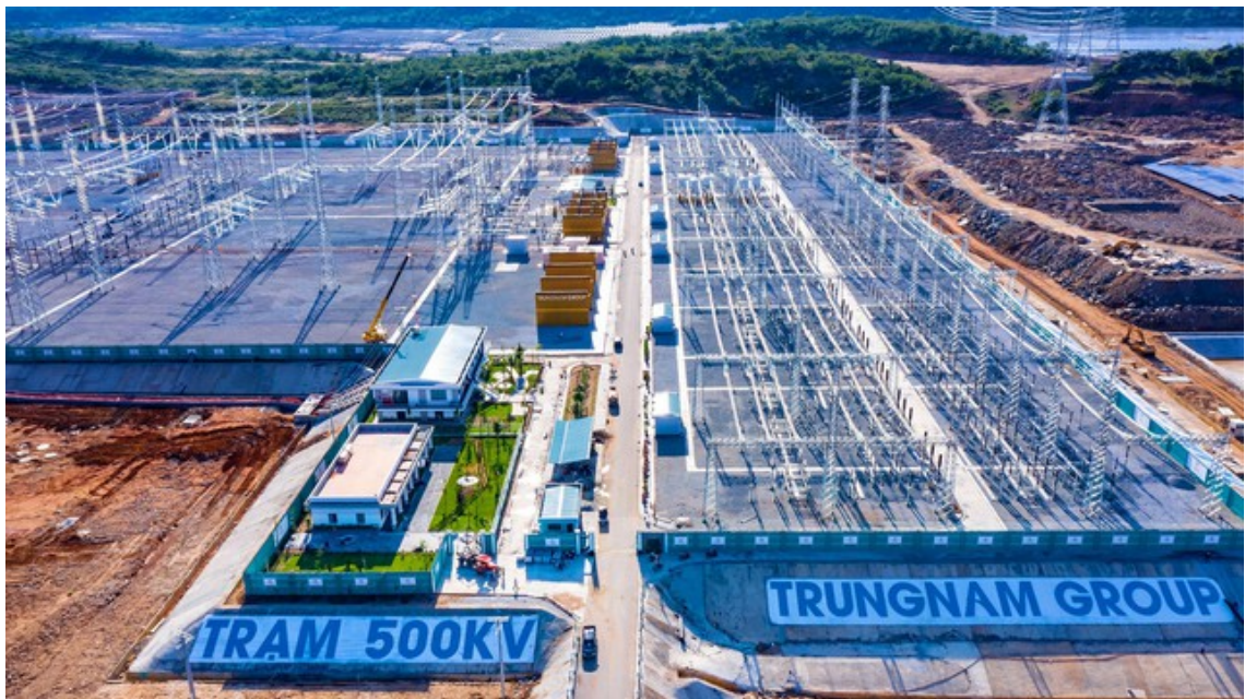
Dự án Trạm biến áp và đường dây 220/500 kV kết hợp Nhà máy Điện mặt trời Trung Nam Thuận Nam 450MW (Ảnh: Trung Nam Group)
