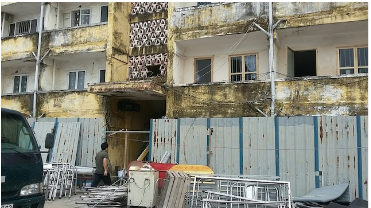
Khu nhà ở Đ10 xuống cấp đã bị các đơn vị thi công tiến hành rào chắn khu vực tầng 1 (Ảnh: PV)
